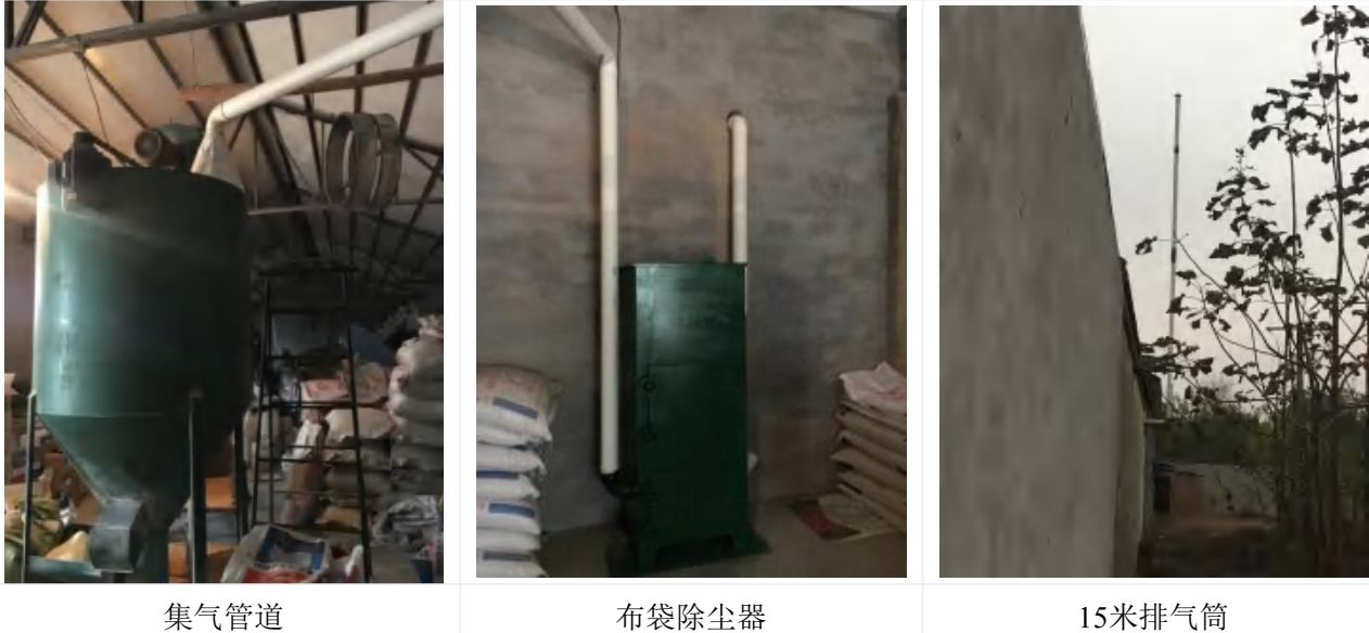
图 8 废气治理设施图片
